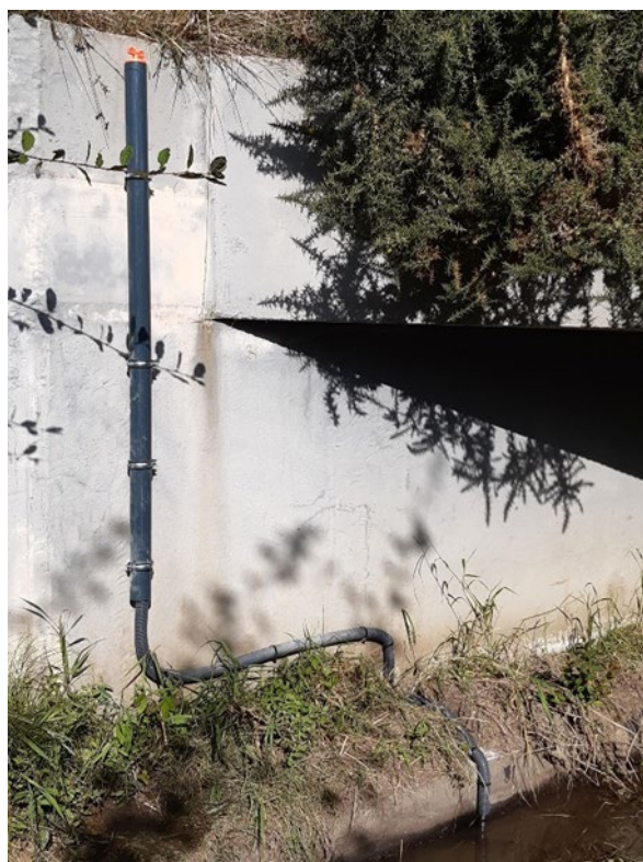
Sonde de mesure du niveau d'eau du cours d'eau
